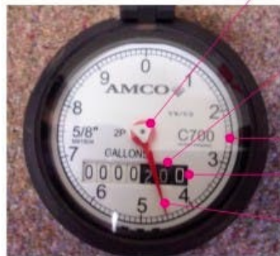
Foresthill PUD Water Meter
